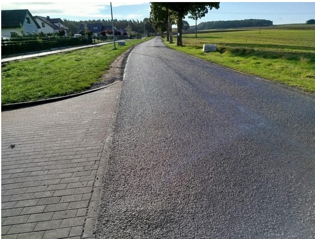
Wykonanie remontu istniejącej nawierzchni bitumicznej poprzez podwójne powierzchniowe utrwalenie emulsją i grysami drogi powiatowej 1082Z na odcinku Psary – Kluczkowo
