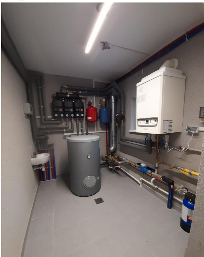
Nowa kotłownia w ramach inwestycji sala sportowa w Zespole Szkół im. Wł. Broniewskiego w Świdwinie. Otwarcie lutego 2025 r.
