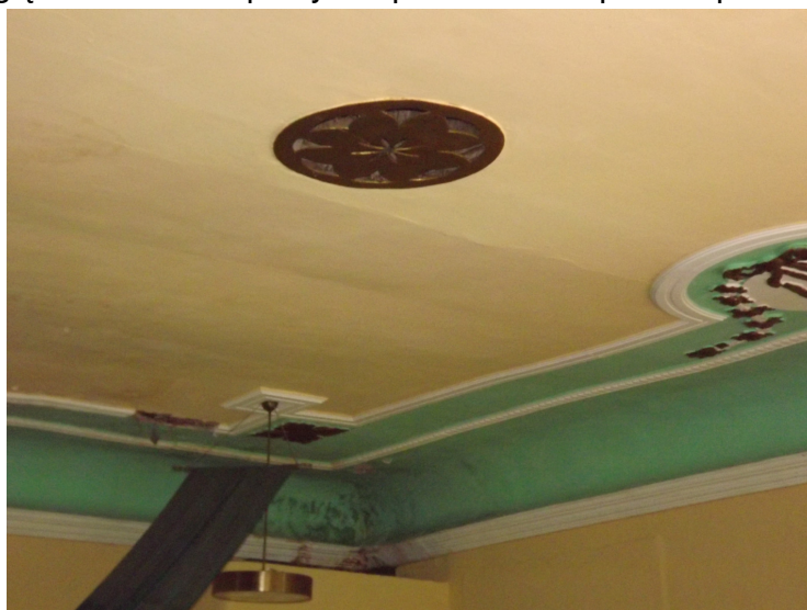
Uszkodzenia tynku sufitu parteru
